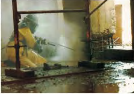
钢混结构的柱子底部破碎
