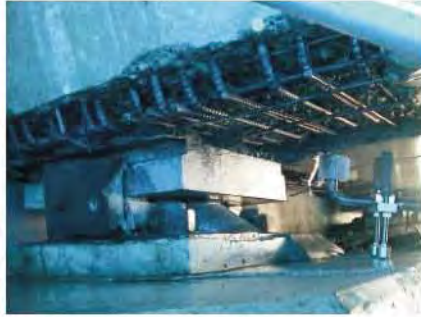
桥墩底部狭小部混凝土破碎
